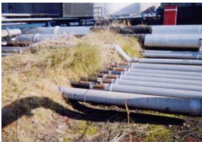
写真 3. AE 計測を実施した製油所の配管
